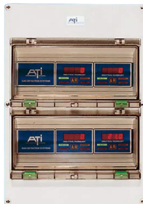
Six Module Enclosure
